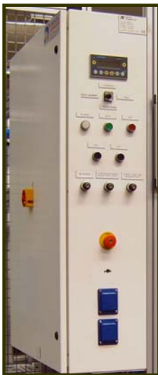
Les distributeurs de puissance
