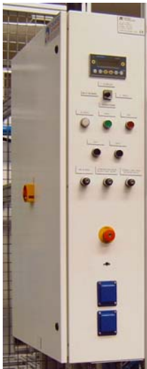
Les équipements de l'armoire électrique
